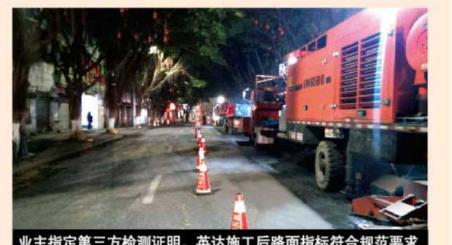
业主指定第三方检测证明，英达施工后路面指标符合规范要求
